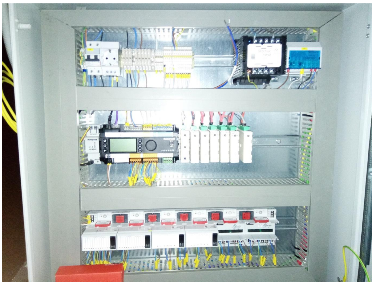
Slika 2: Elektro omarica z krmilnikom za upravljanje z avtomatskimi vrati
